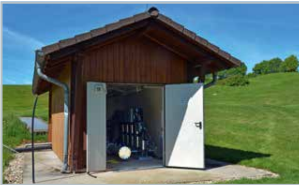
Vom Pumpenhaus neben den Speicherteichen wird das Beregnungswasser mit der Grundfos-Druckerhöhungsanlage in das weitverzweigte Bewässerungsnetz eingespeist.
