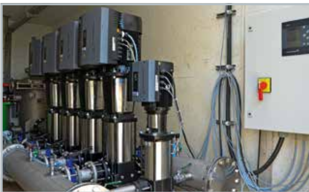
Die elektronisch geregelte Druckerhöhungsanlage vom Typ Hydro MPC-E 4CRE45-4 mit zusätzlicher, fünfter Kreiselpumpe CRE10-9 ist für eine Förderleistung bis zu 120 m 3 /h ausgelegt und sorgt für einen konstanten, netzschonenden Versorgungsdruck
